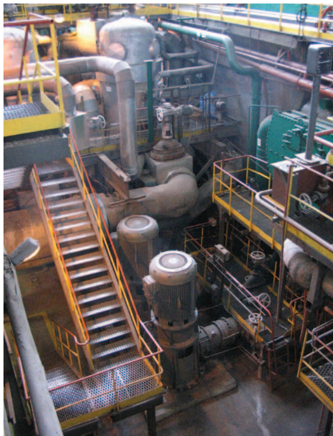
Machine room inside Elektrociepłownia Gorzów
